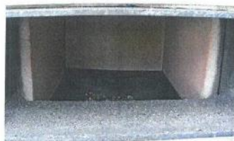
Płyty ceramiczne w komorze spalania
