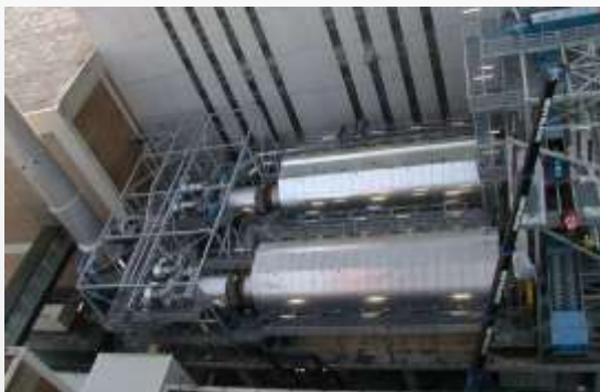
Instalacja Hamm-Uentrop, Niemcy – 100 000 Mg MSW/rok
