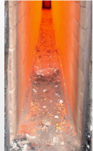
Zapadnięcia trzonu komory koksowniczej
