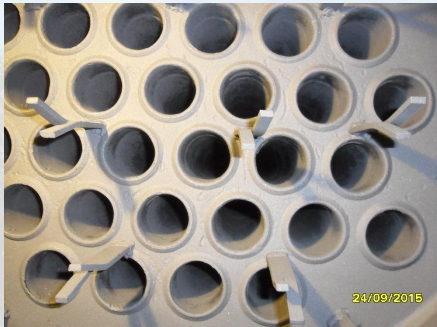
wypiaskowana ściana sitowa kotła WC
