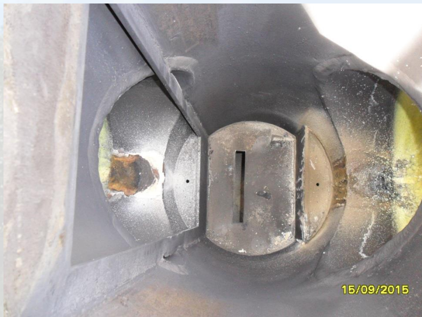
wnętrze separatora siarki
