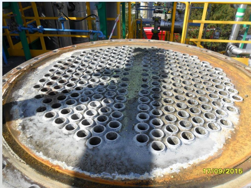
ściana sitowa podgrzewacza gazu procesowego
