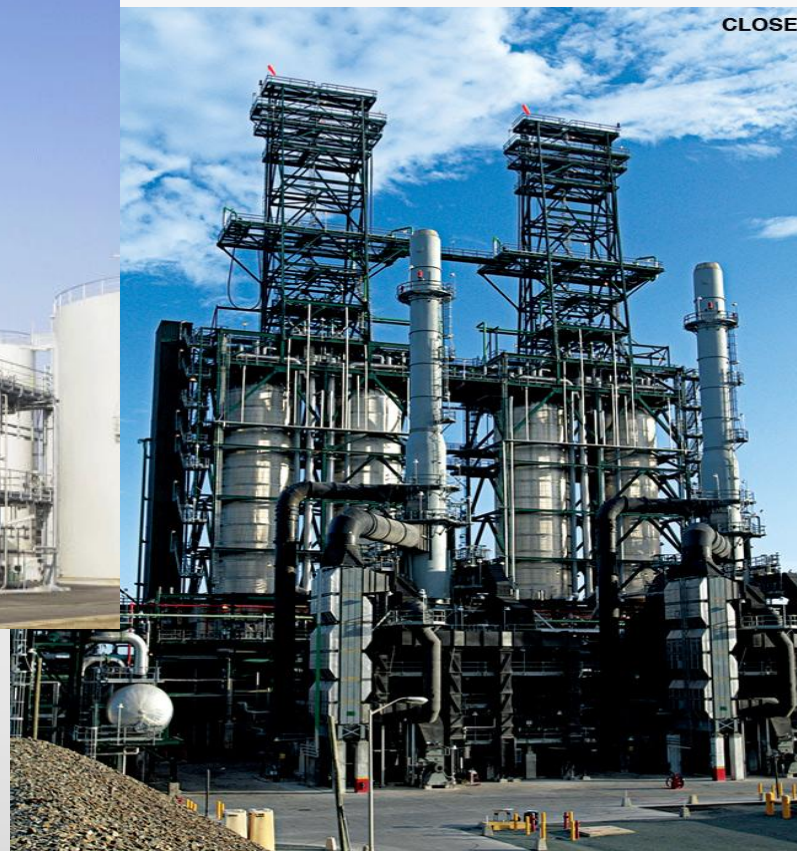
Instalacja zwolnionego koksowania
